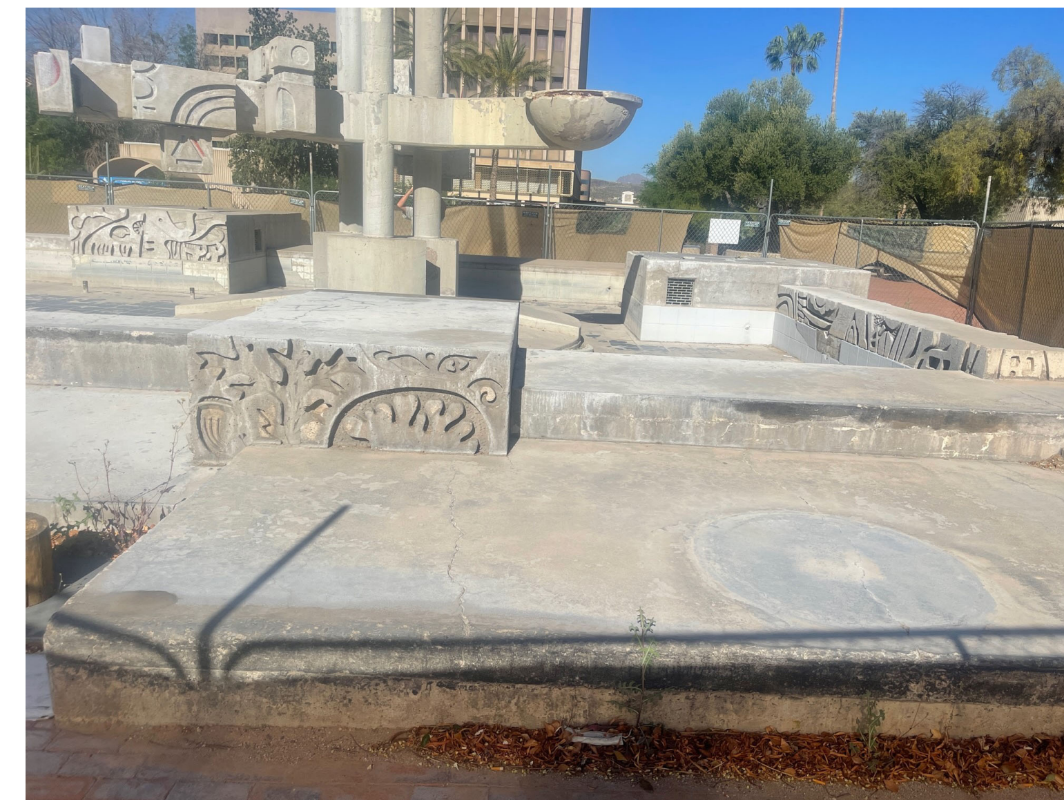
EAST EDGE CONDITION
